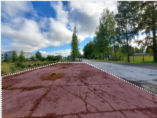
Высокий процент износа твердых покрытий
