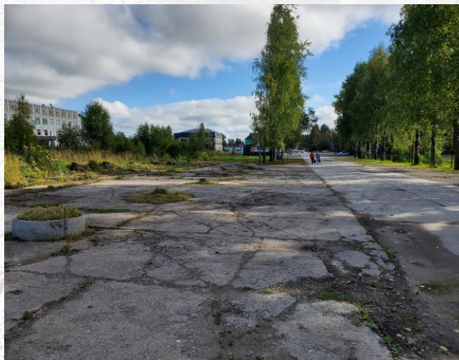
Высокий процент износа твердых покрытий
