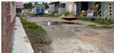
Отсутствие твердых покрытий
