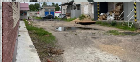
Отсутствие твердых покрытий
