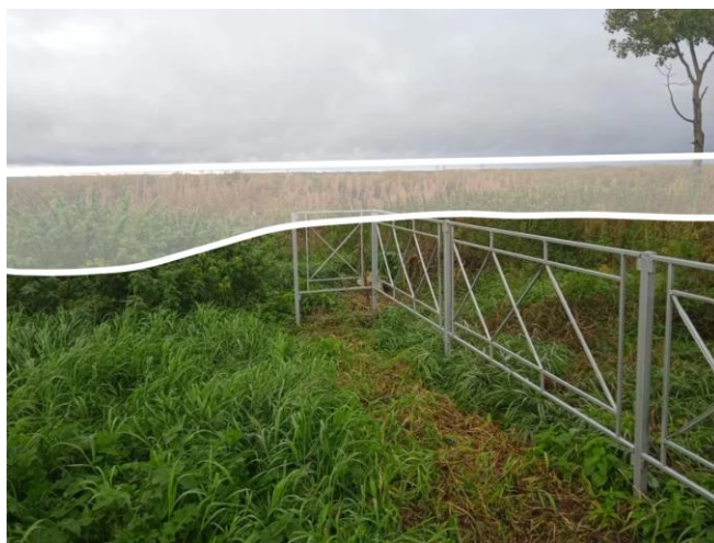
ТЕРРИТОРИЯ НЕБЕЗОПАСНА И ТРЕБУЕТ ОГРАЖДЕНИЯ
